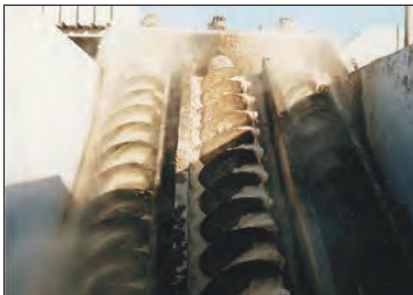
Kolme jätevesipumppua toiminnassa ennen korjausta
