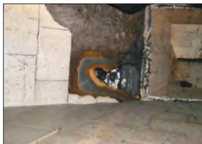
Laatoilla vuoratun kuilun vaurioituminen neljän kuukauden kuluttua ennen paikkaushitsausta.
